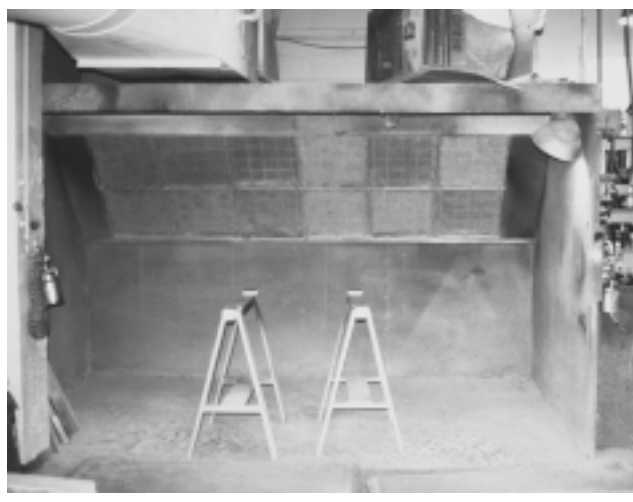
Figura 61.4 • Cerramiento parcial: cabina de pintura con pistola pulverizadora.
