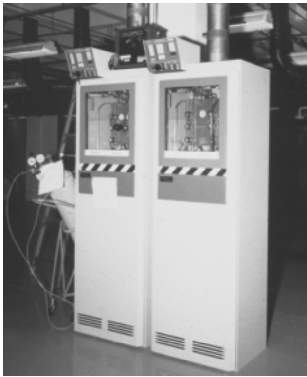
Figura 61.2 • Cerramiento completo: cámara de almacenamiento de gas tóxico.
